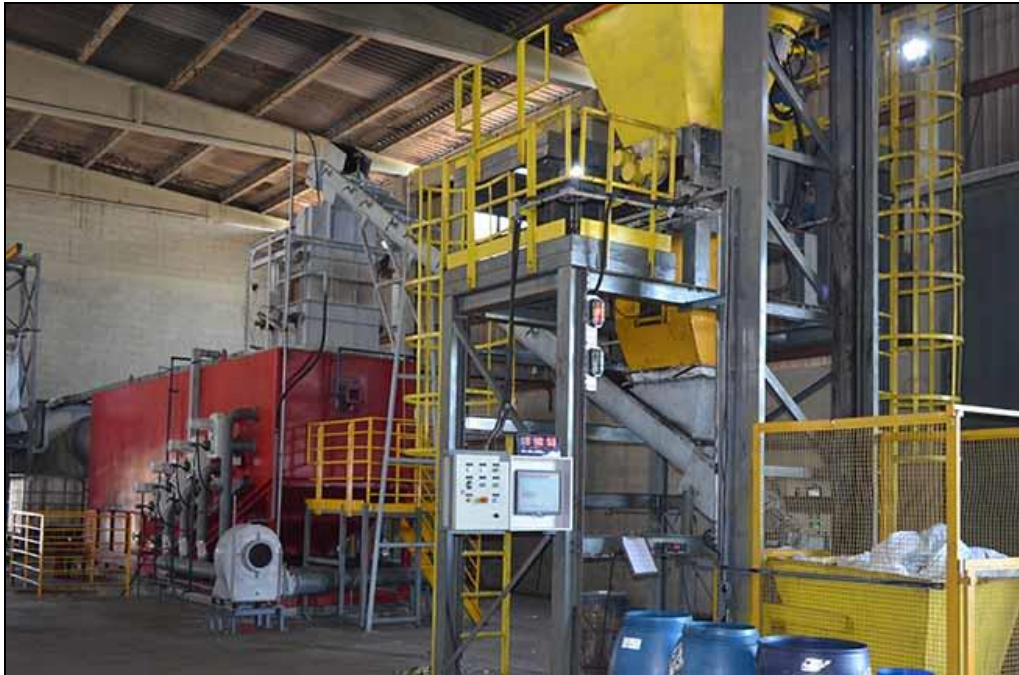
Figura 22 – Unidade de tratamento de RSS da Empresa Pró Ambiental Tecnologia Ltda.
