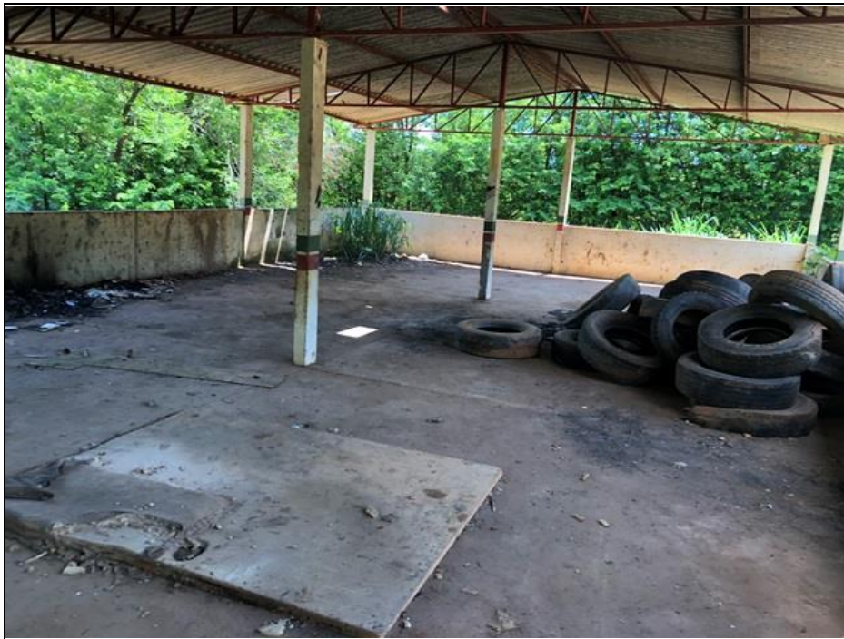
Figura 28 – Pneus armazenados na área contígua ao transbordo
