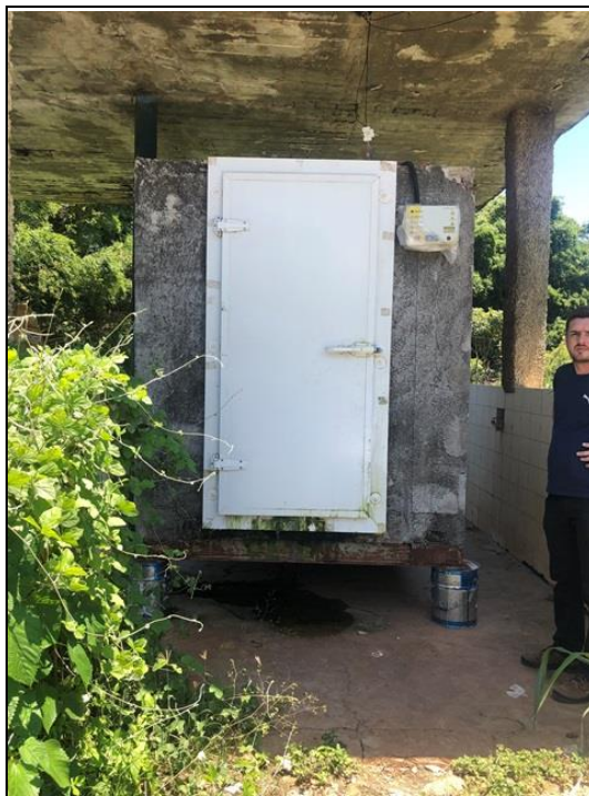
Figura 24 – Vista externa da câmara fria Fonte: Premier Engenharia, 2024.
